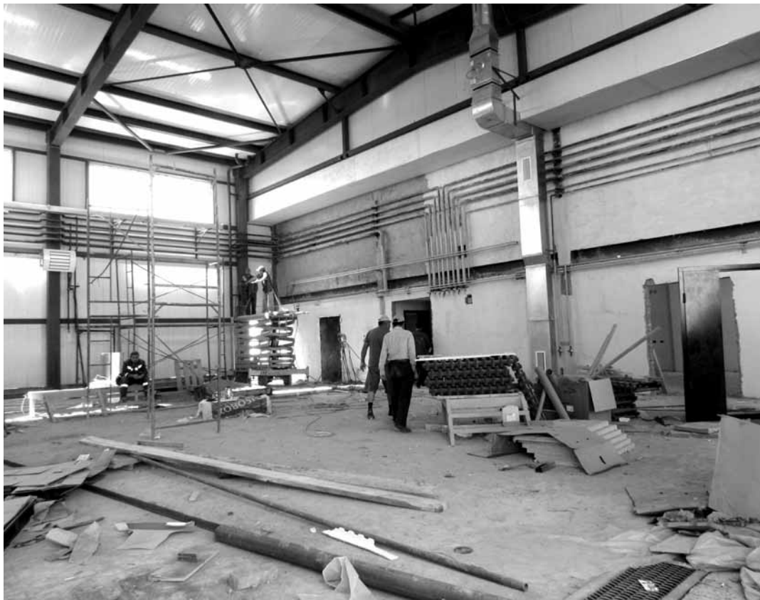
Реконструкция аэропорта должна быть завершена в декабре 2018 года. В настоящее время подрядчики укладываются в этот срок. Фото: автора
