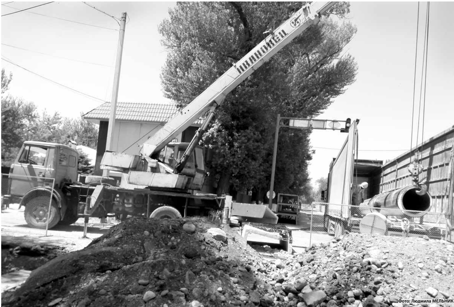
В ТОО «Tehno Construction Company» уверяют, что на их траншеях обвалов не было.
